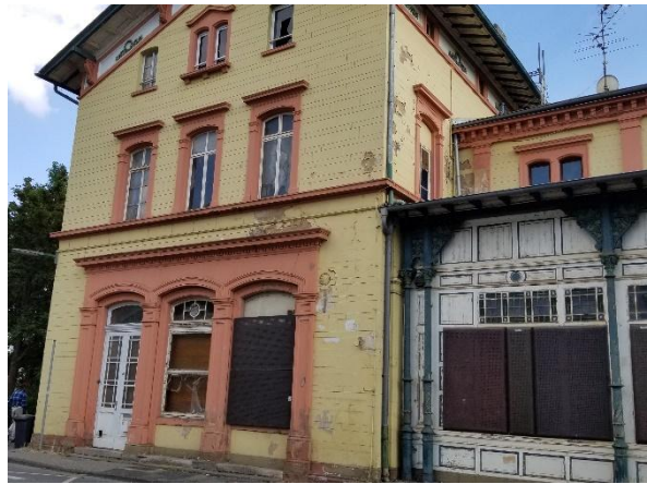
Abbildung 27: Auch das Bahnhofsgebäude ist dringend sanierungsbedürftig
