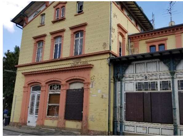
Abbildung 27: Auch das Bahnhofsgebäude ist dringend sanierungsbedürftig
